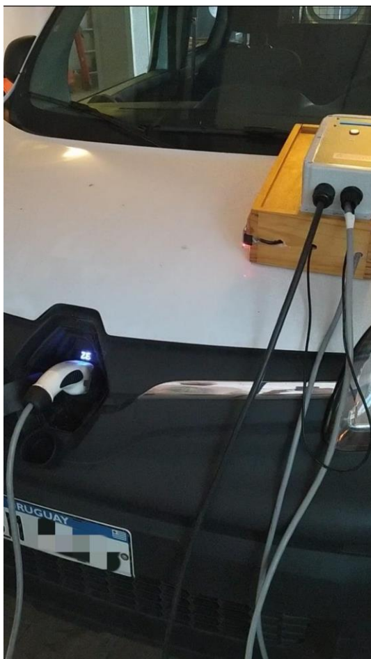
Ilustración 22 – Carga de vehículo eléctrico en proceso
