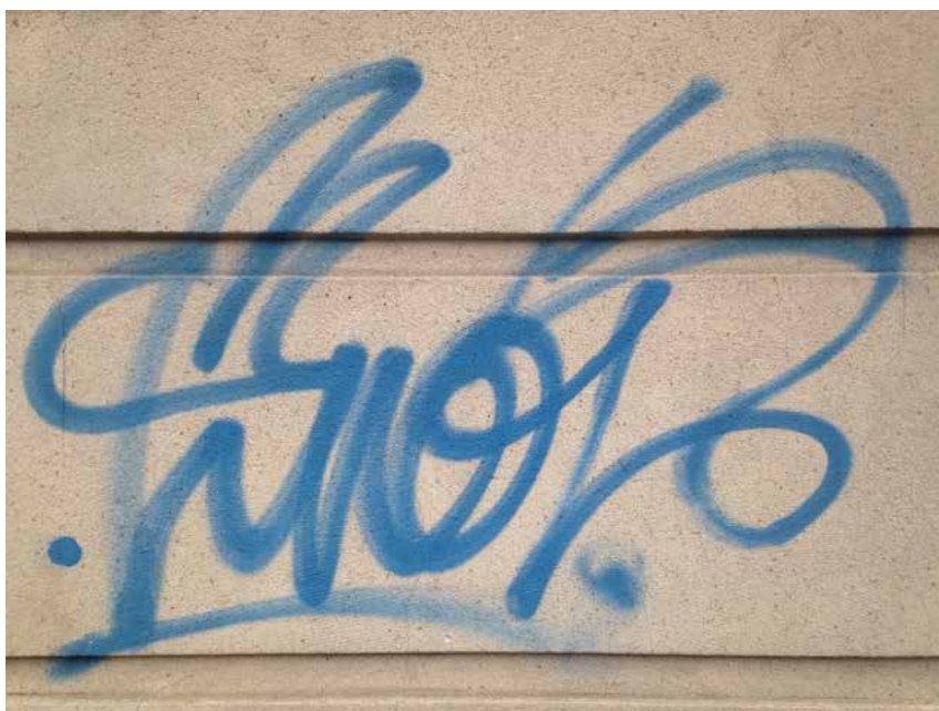
Figura 1. Grafiti tag en fachada de casa particular, Av. 8 de Octubre, Montevideo. Foto: Richard Danta, 2017
